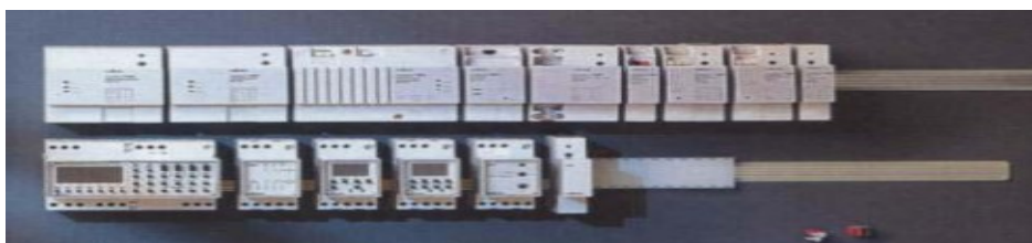
Фиг.10. Монтиране на устройства в таблото на DIN шина
